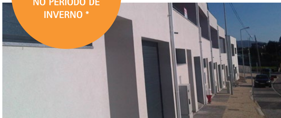
Mário & Amadeu: Construção de moradias em banda (ITE em suporte de alvenaria)
